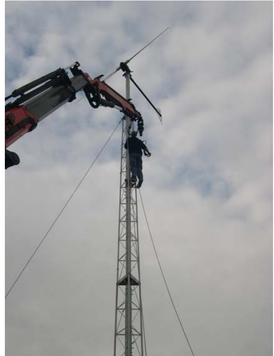
Haubanage du mât.
